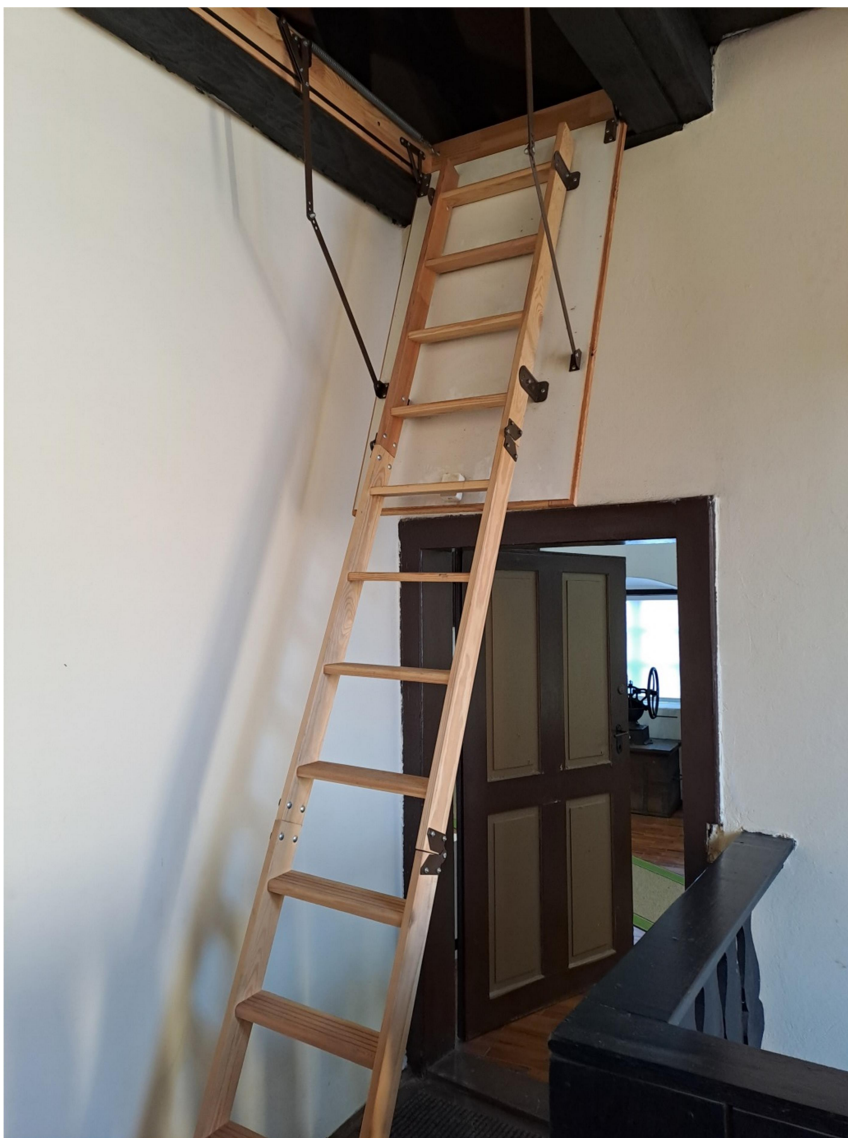
Foto 5. Neprikladne i opasne sklopive stube koje vode u potkrovlje kuće Karas gdje se nalazi improvizirana čuvaonica
